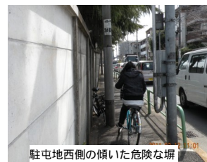
駐屯地西側の傾いた危険な塀
